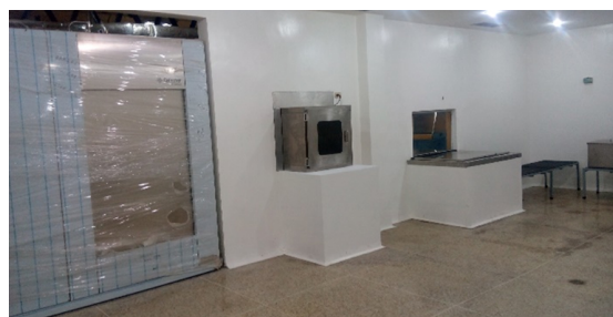
Figura 9. Área de acondicionamiento de material autoclave doble puerta, Sistemas de Acceso Seguro (SAS).
