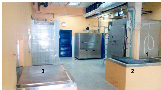
Figura 4. Tanques. 1) Prelavado, 2) lavado y 3) germicida Fuente: elaboración propia
