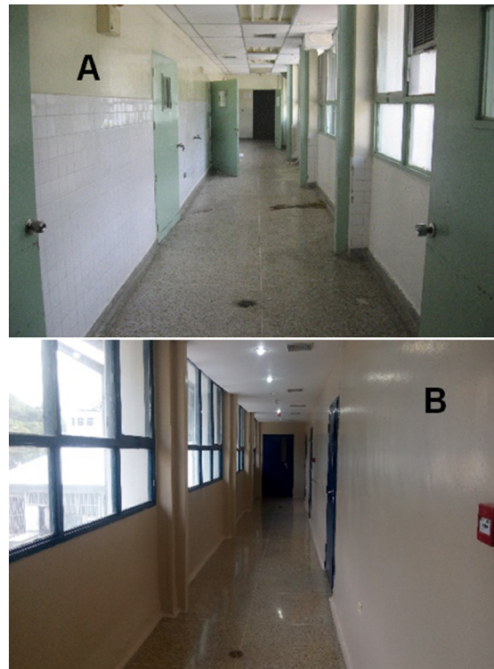
Figura 2. Área de pasillos. A: antes de la remodelación: paredes con baldosas y techo tipo cielo raso. B: después de la remodelación, remoción de baldosa, sustitución de techo estructuras de dry wall Fuente: elaboración propia
