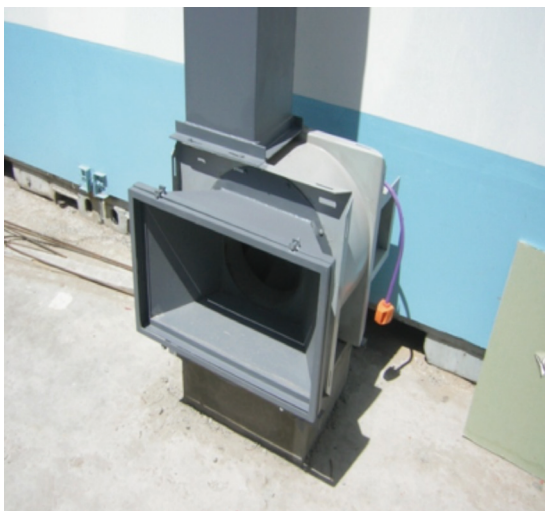
Figura 2. Toma de ingreso de aire externo
