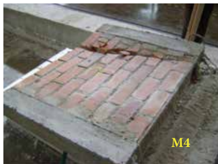
Figura 13. Parapeto M4-Fase 3. Falla por anclaje del refuerzo vertical
