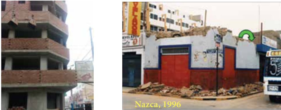
Figura 1. Parapeto de albañilería sin arriostar y volcamiento
