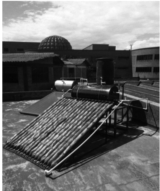
Figura 10. Ensamble del tanque, el captador solar, los instrumentos y accesorios para su correcto funcionamiento Fuente: elaboración propia
